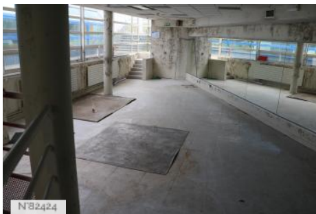
Complexe sportif Agora – Espace délabré - salle de sport
