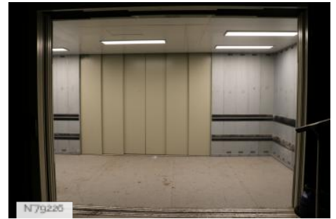
MC93 - Maison de la Culture de Seine-Saint-Denis- Freight elevator
