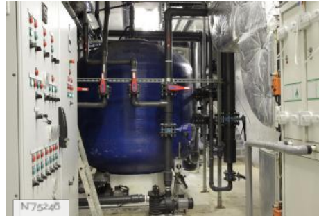
Piscine Le Nautille - Niveau technique
