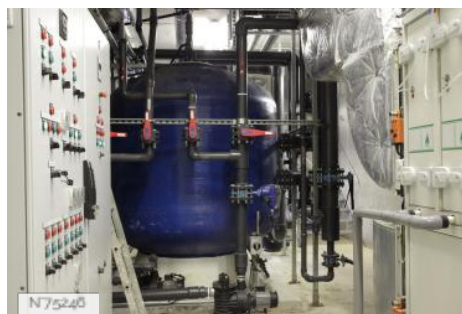
Piscine Le Nautille - Niveau technique
