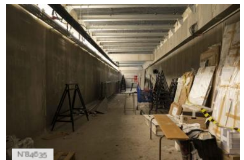
N°84635 Ecole Nationale Supérieure d'Architecture (ENSA) Paris-Val de Seine - Sous-sol
