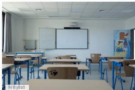
N°83816 Ville de Saint-Ouen-sur-Seine - École élémentaire Jean De La Fontaine - Salles de classe
