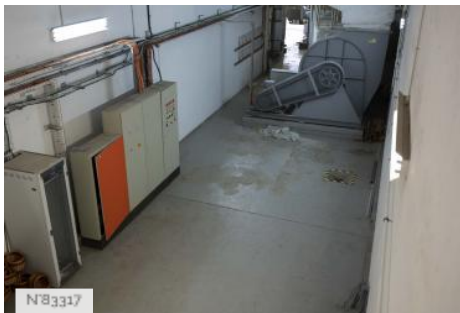
Opéra National de Paris - Opéra Bastille - Chaufferie
