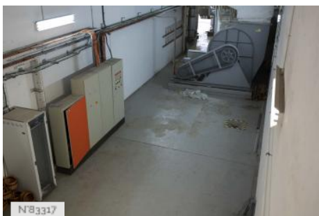
Opéra National de Paris - Opéra Bastille - Chaufferie
