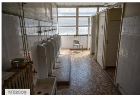
Aérodrome de Melun-Villaroche - Sanitaires désaffectés
