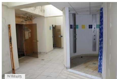
Complexe sportif Agora – Espace délabré - Vestiaires avec hammam et sauna
