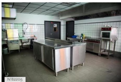
Ville d'Evry-Courcouronnes - Centre social Brel-Brassens - Office traiteur
