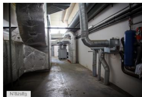
Ville d'Evry-Courcouronnes - Complexe sportif du Lac - Chaufferie
