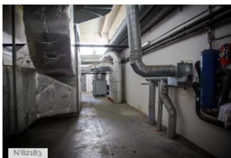
Ville d'Evry-Courcouronnes - Complexe sportif du Lac - Chaufferie
