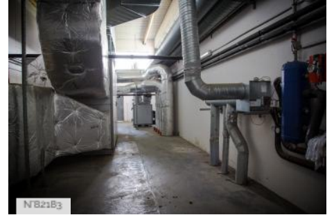
Ville d'Evry-Courcouronnes - Complexe sportif du Lac - Chauffage
