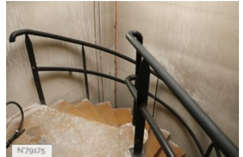
N79175 MC93 - Maison de la Culture de Seine-Saint-Denis- - Escalier d'accès au grill, tour pompier
