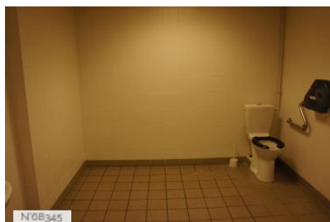
Préfecture des Hauts-de-Seine - Toilettes
