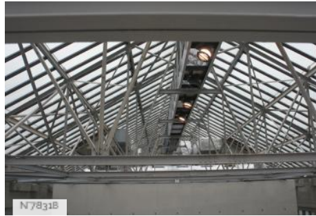
Musée de l'Orangerie - Combles techniques
