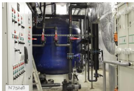
Piscine Le Nautille - Niveau technique
